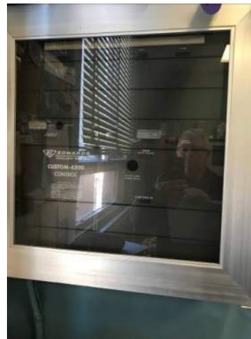
Intercom Paging Console
