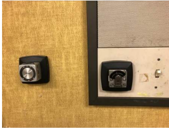
Existing Pneumatic T-Stats
